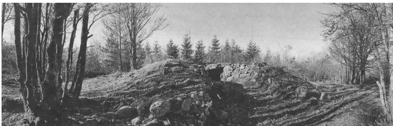
Finalizados los trabajos de reconstrucción, el dolmen de Kerexetaegia hegokoa ya puede verse en su disposición original. Foto: N.G.
